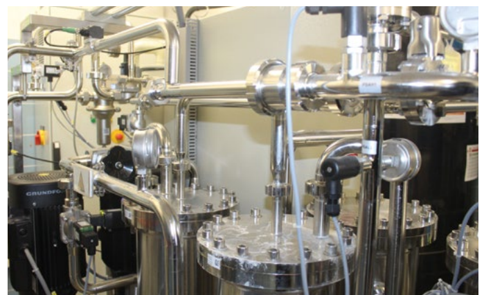
En immersion dans la salle des machines qui permet de recycler l'eau osmosée.
